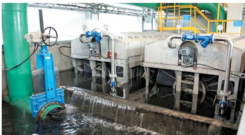
В ходе реконструкции очистных сооружений установлены два дисковых микроситовых фильтра производительностью 1 000 м 3 в час каждый
